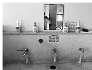
※トイレの流しに液体洗剤と消毒液を設置
